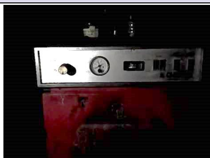
Photo Chaudière fuel chappee Localisation : Sous-Sol - Chaufferie Ouvrage :
