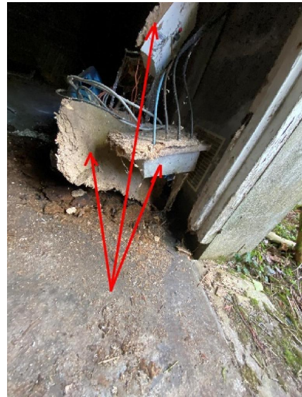
B.7.3 e) : L'installation électrique comporte au moins un dispositif de protection avec une partie active nue sous tension accessible. Observation : Installation électrique (AGCP/Compteur/...)
