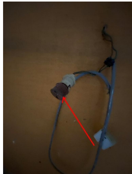
B.8.3 b) : L'installation comporte au moins un matériel électrique inadapté à l'usage. Observation : Matériel inadapté à l'usage.
