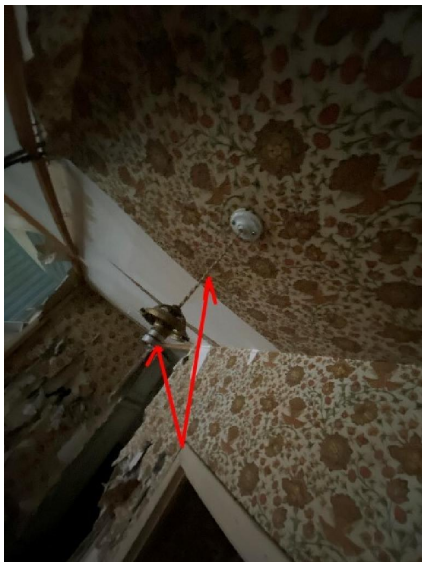
B.8.3 a) : L'installation comporte au moins un matériel électrique vétuste. Observation : Matériel vétuste.
