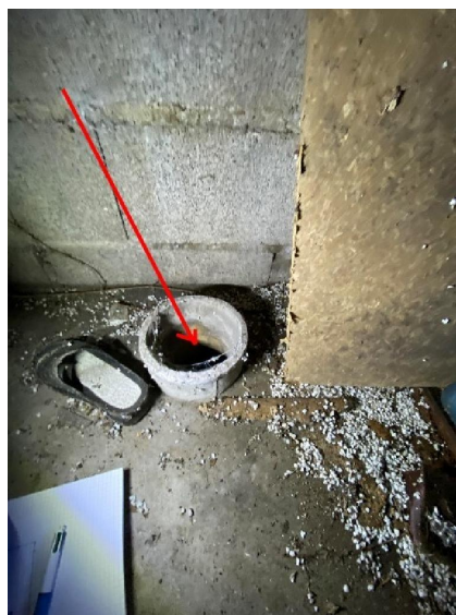
Garage 01 Conduit fibre-ciment.
