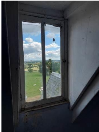
Photo n° PhTer039 Localisation : 3ème étage - Pièce 4 Ouvrage : Fenêtre(s) en bois Informations complémentaires : Vitrage brisé
