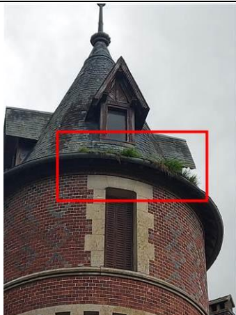
Photo n° PhTer040 Localisation : Extérieur - Façades Ouvrage : Plafond - Ardoises Informations complémentaires : Certaines gouttières sont encombrées par de la végétation : obstruction de la collecte des EP et débordements avec ruissellements sur la façade
