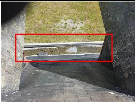
Photo n° PhTer040 Localisation : Extérieur - Façades Ouvrage : Plafond - Ardoises Informations complémentaires : Certaines gouttières sont encombrées par de la végétation : obstruction de la collecte des EP et débordements avec ruissellements sur la façade
